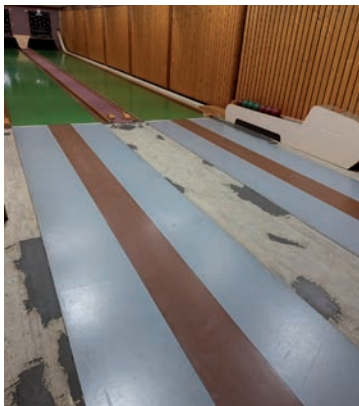
renovierte Kegelbahn des SVO nach Wasserschaden
